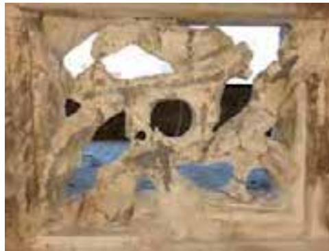
Figura 32. Estado ruinoso de la tracería calada del antepecho.
