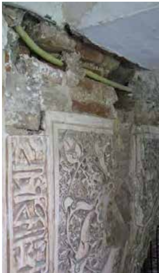
Figura 19. Eliminación de restos de pastas de yesos, de escayolas y de morteros de cemento bajo el alfiz.
