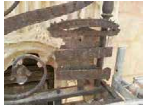
Figura 33. Deterioro de la reja del siglo XVI y sus escudos.
