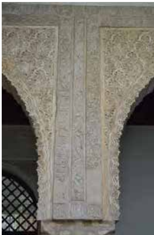
Figura 7. Presencia de clavos embutidos, visibles por su corrosión, utilizados para la fijación de las placas supuestamente primitivas.
