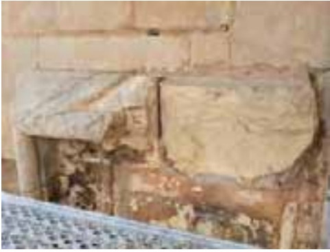
Figura 28. Pérdida de material y restos de revestimiento rojo.
